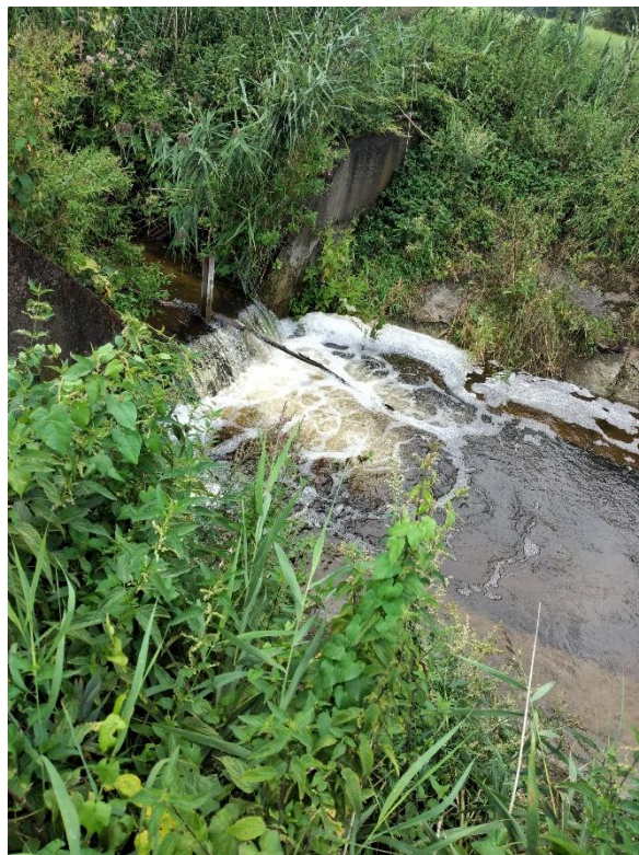
Fot. 4 Widok na pozostałości stopnia z piętrzeniem w km 24+107, fot. Maciej Wachecki.
