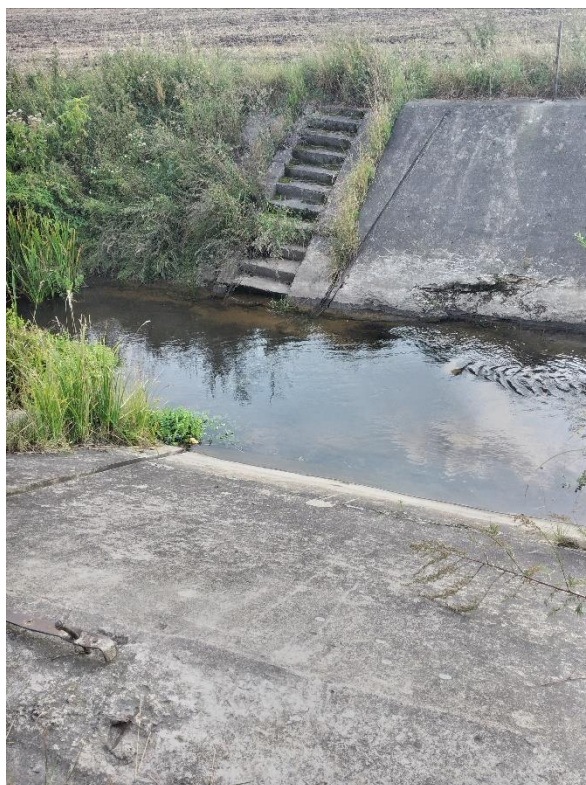
Fot. 2 Widok na pozostałości jazu kozłowego w km 5+640, fot. Kamil Mazur.
