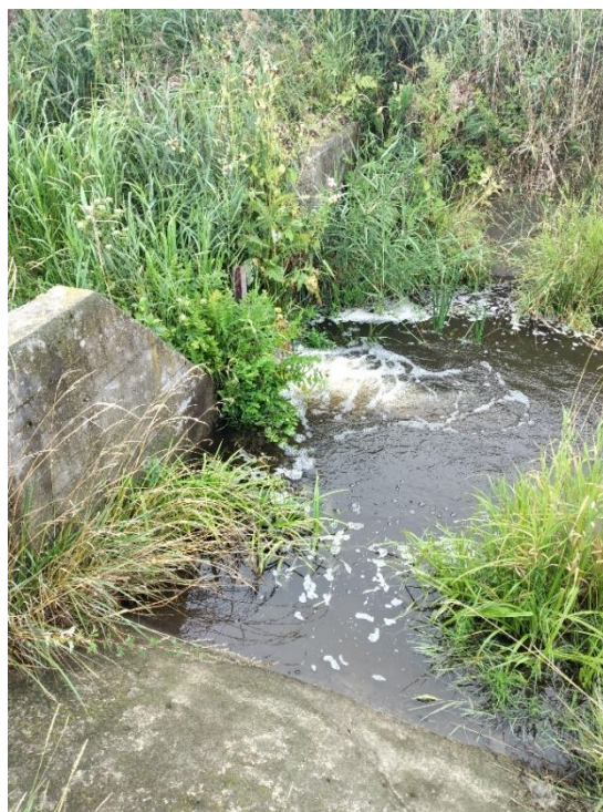
Fot. 5 Widok z pozostałości stopnia z piętrzeniem w km 29+150, fot. Maciej Wachecki.
